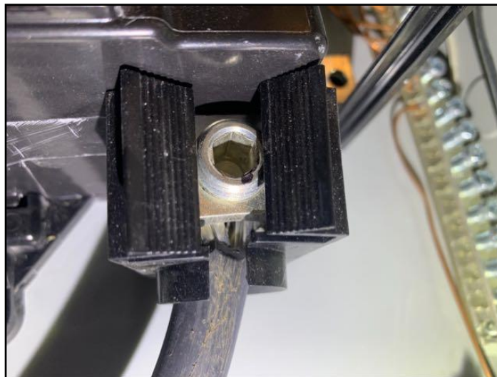
Main Breaker Lug
